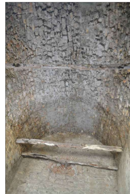
Fig. 76: Probleme me qemerin e kullës Nr.24. Arsyeja: hidroizolimi jo i mirë i kullës në pjesën e sipërme të duke sjellë degradimin e materialit lidhës dhe depërtimin e ujërave të shiut. Foto: Dritan Çoku, 17.05.2021, DRTK-Berat.
