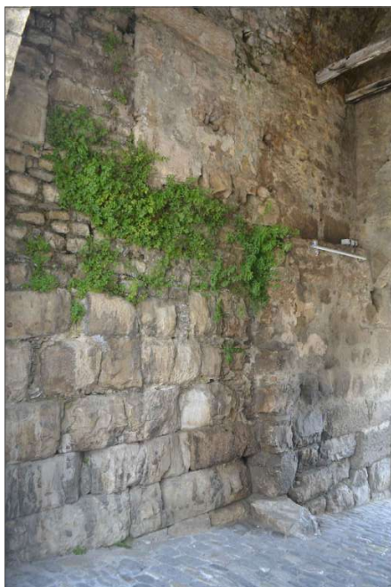
Fig. 74: Faqja e brendshme veriore e kullës Nr.24, e cila ka gjithmonë lagështi, si rezultat i mbartjes së dherave në faqen e jashtme të kullës dhe mungesës së një kanali hidroizolues. Foto: Dritan Çoku, 17.05.2021, DRTK-Berat.
