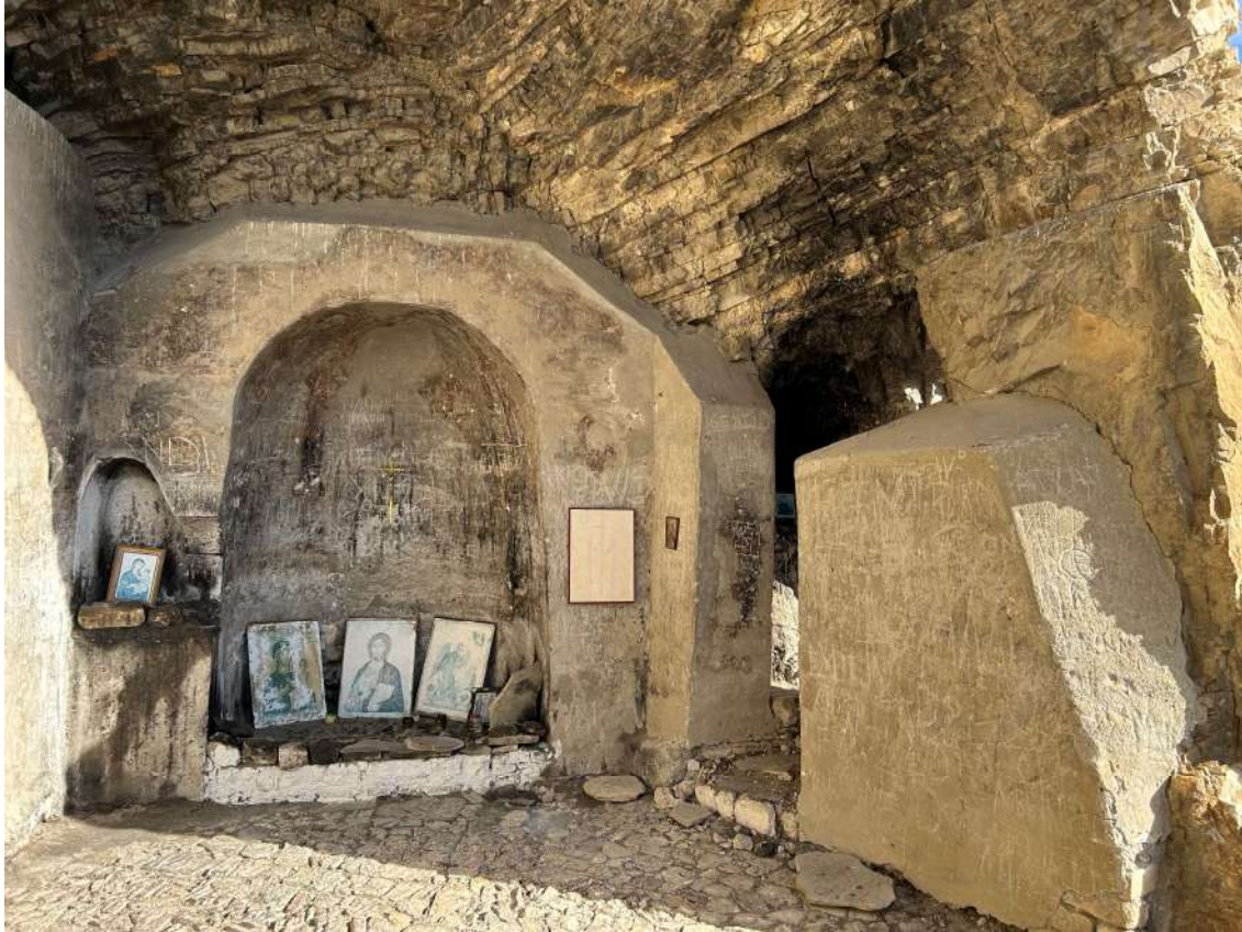
Figura 9. Kishe shpell Kostandini dhe Elena gjendja ekzistuese e muraturës
